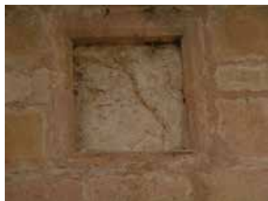
Fig. 2 - Recuadro picado sobre la puerta de acceso del muro este
